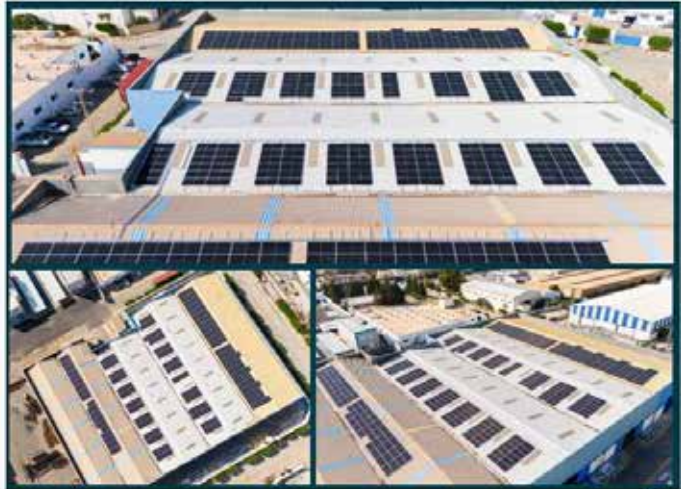
Installation de 228 kWc en régime d'autoconsommation à El Fahs
