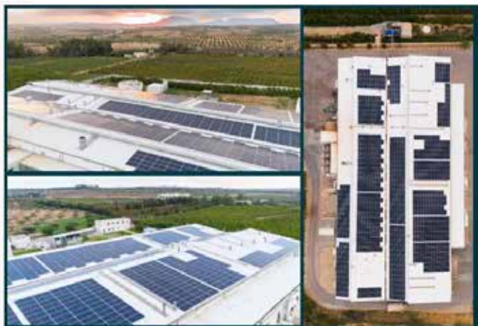
Installation de 601 kWc en régime d'autoconsommation à Saouef
