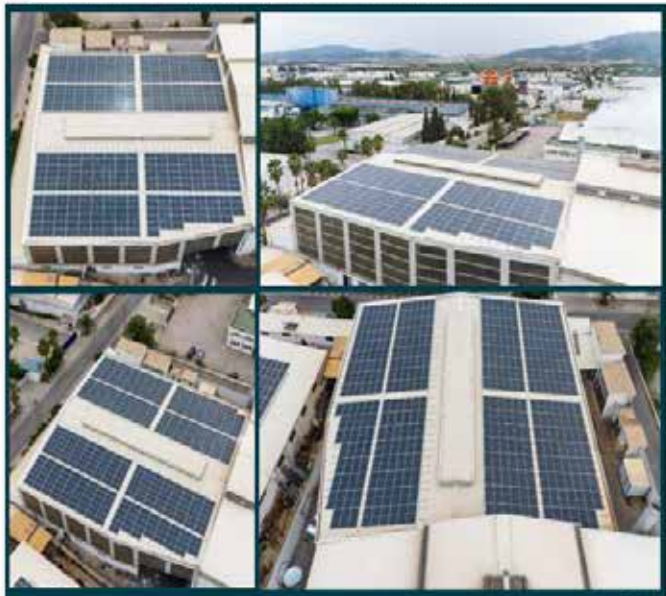
Installation de 223 kWc en régime d'autoconsommation à Grombalia
